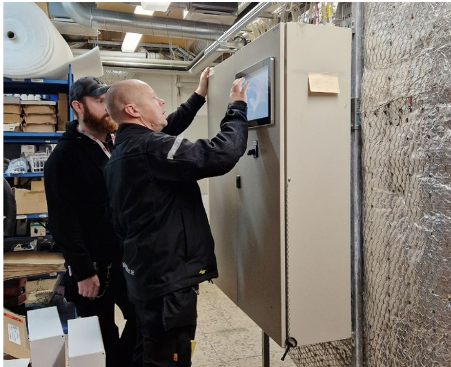
Roslagsbostäders drifttekniker Tomas och Pontus justerar in husets driftssystem så att bland annat inomhusvärmens och varmvattnet håller rätt temperatur.
